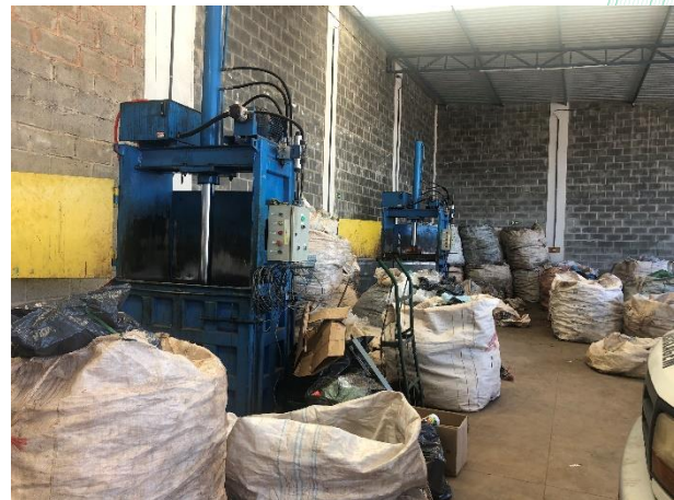
Figura 41 - Máquinas de prensa da Cooperativa Fonte: Amplar Engenharia
