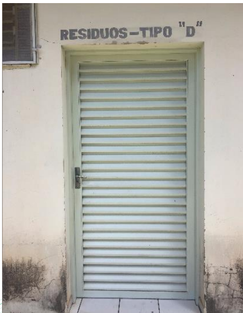
Figura 23 - Separação interna dos resíduos no Hospital Fonte: Amplar Engenharia
