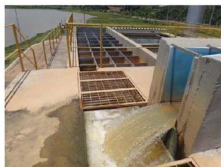
Foto 4.3 – Chegada da Água Bruta
