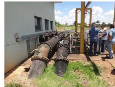
Foto 4.8 - Adutoras de Água Bruta e Tratada
