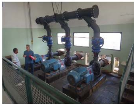
Foto 4.7 - Recalque Água Tratada
