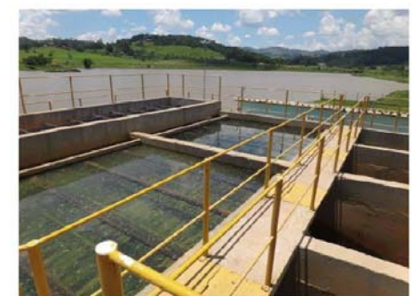
Foto 4.4 – Vista de um módulo da ETA
